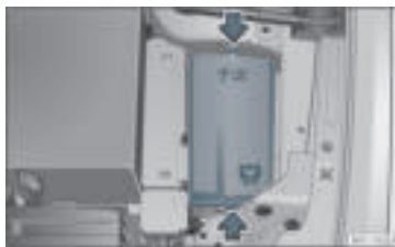
Rys. 52 W komorze silnika: pokrywa skrzynki bezpiecznikowej.
